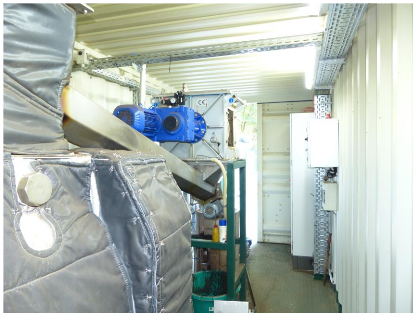
Abb. 4: Innenansicht 2 – Blick auf den integrierten Pressschneckenseparator
